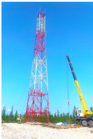
Рис. 1. Антенно-мачтовое сооружение связи
